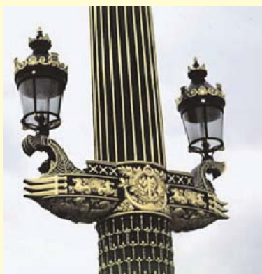
Protection anticorrosion par un système glycérophthalique, décor avec une dorure à la mixtion
