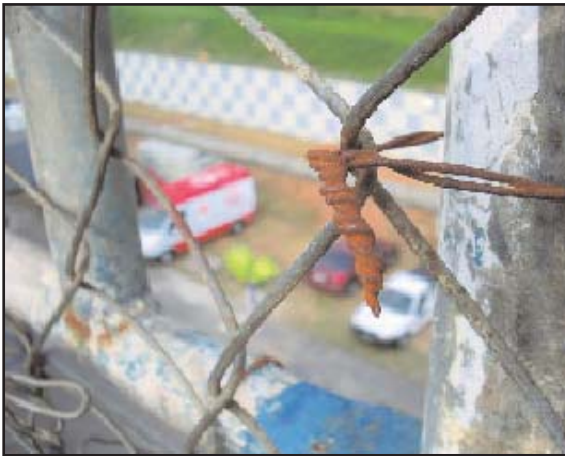
Corrosion du fer
